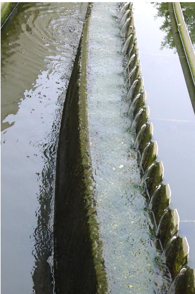
Het gezuiverd water stroomt over de overstortrand van de cirkelvormige nabezinktank naar de Molse Nete.
